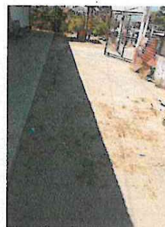
Foto 4: El concreto del patio delantero de la escuela esta deteriorado con grietas y no esta nivelado.
