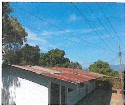
Foto 3: Lámina: se encuentra oxidada y con agujeros tanto de las aulas como bodegas
