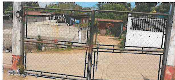
Foto 2: Portón: las bases se encuentran oxidadas, la malla con agujeros y desprendida de las bases.
