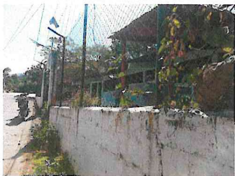
Foto 1: Muro: los cimientos se encuentran dañados la malla oxidada y desprendida de las soleras y tubos oxidados.
